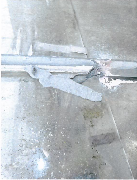
Foto 3: grauer, asbesthaltiger Fensterkitt (P 1)
